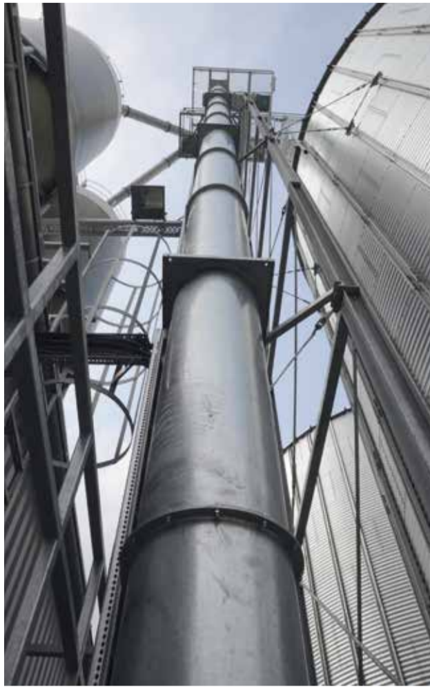
Das Pelletlager in Rommerskirchen hat eine Kapazität von 3.500 Tonnen. Die beiden Verladesilos fassen jeweils 30 Tonnen.
